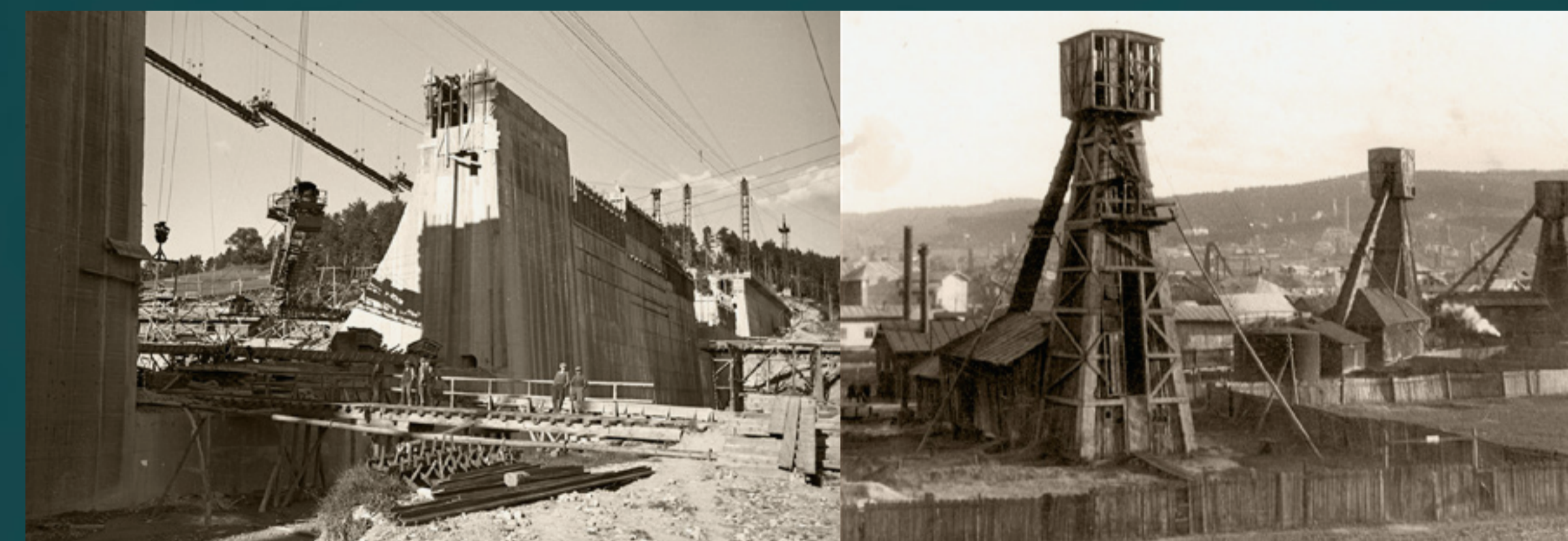
Budowa zapory i elektrowni wodnej na Dunajcu w miejscowości Rożnów, początek 1935 r.
